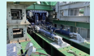
スライド架台設備
