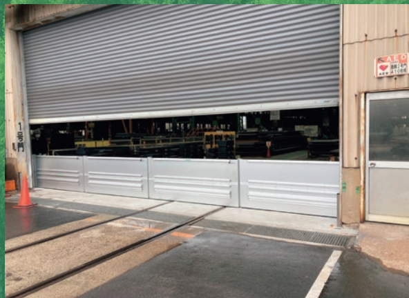
大雨などによる浸水被害に備え、大阪工場の建屋入り口に止水板を設置
