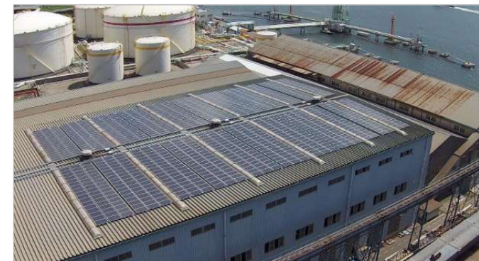
工場屋根の太陽光パネル
