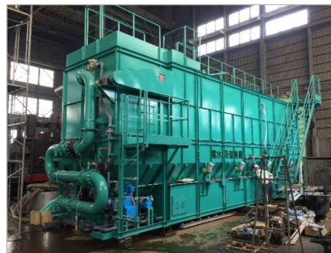
シックナー(濁水処理装置)
