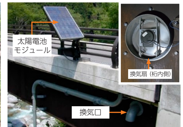
桁内換気システム
