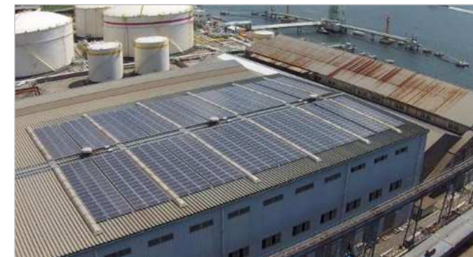
工場屋根の太陽光パネル
